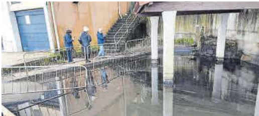
El lavadero de A Regueira, anegado de agua y residuos. | S.A.
